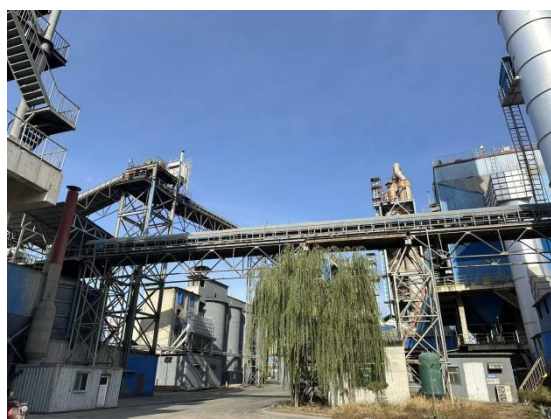
全封闭输送带
