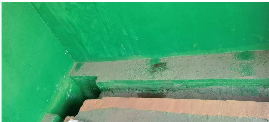
导流渠、积液池
